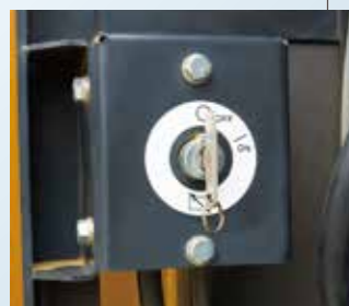
▲配置了蓄电池断电开关
